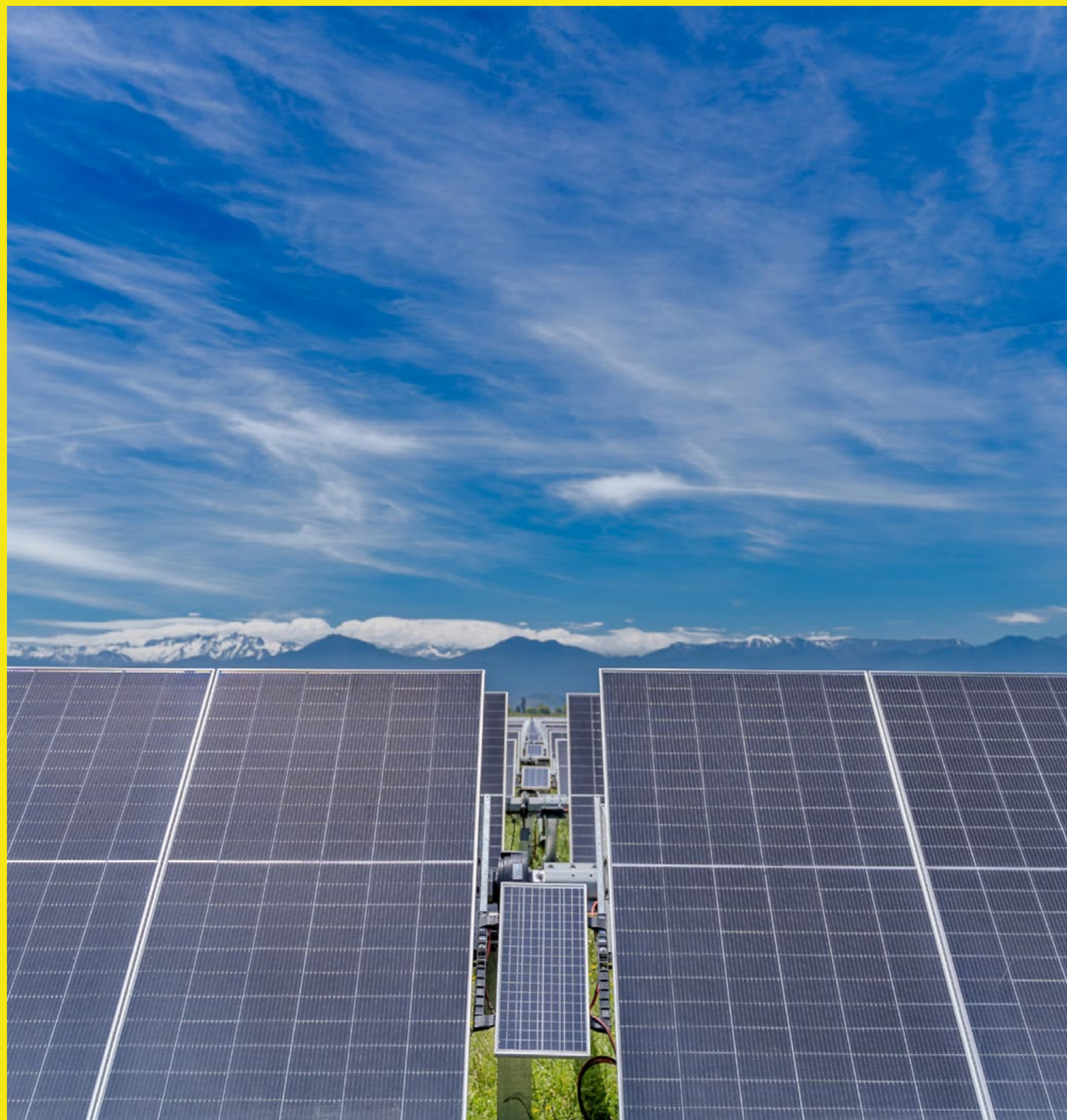
Planta FV Gran Teno 200 MW, Chile
