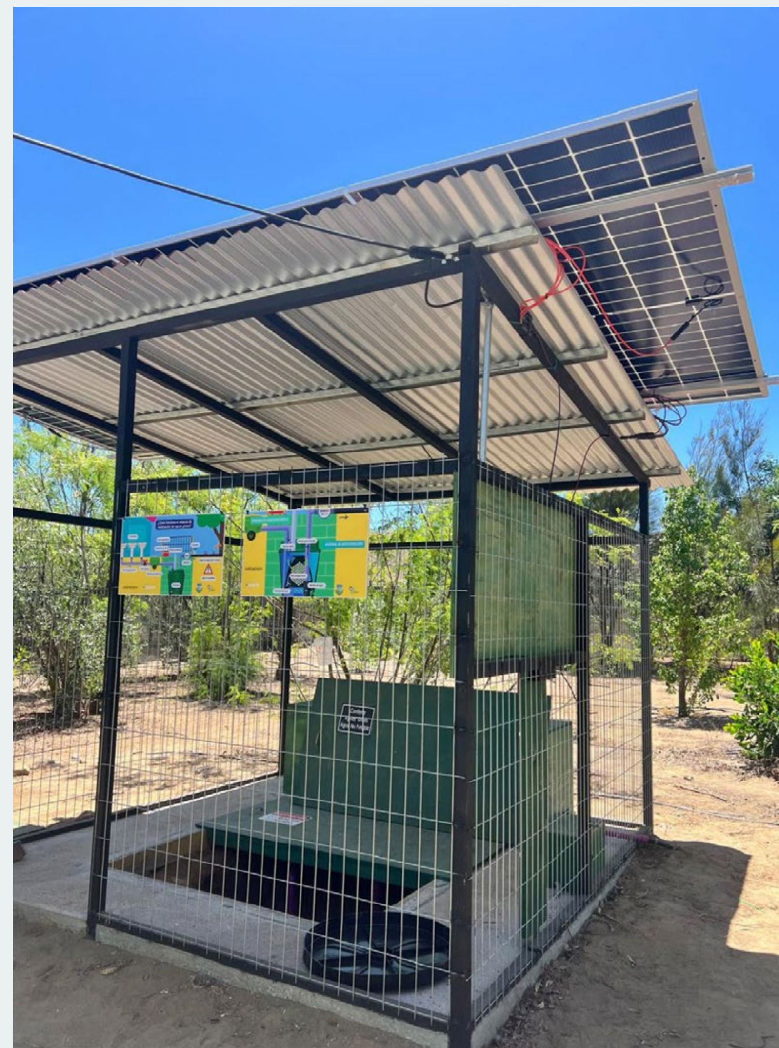
Bomba alimentada por paneles solares
