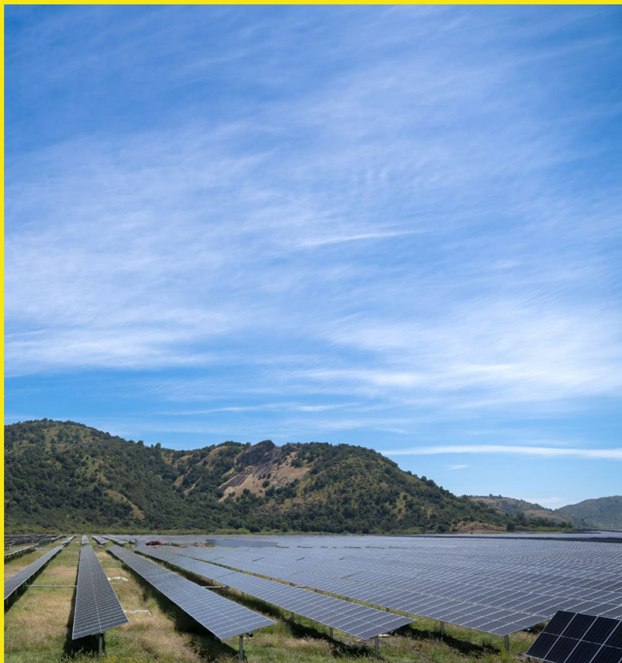
Planta FV Gran Teno 200 MW, Chile
