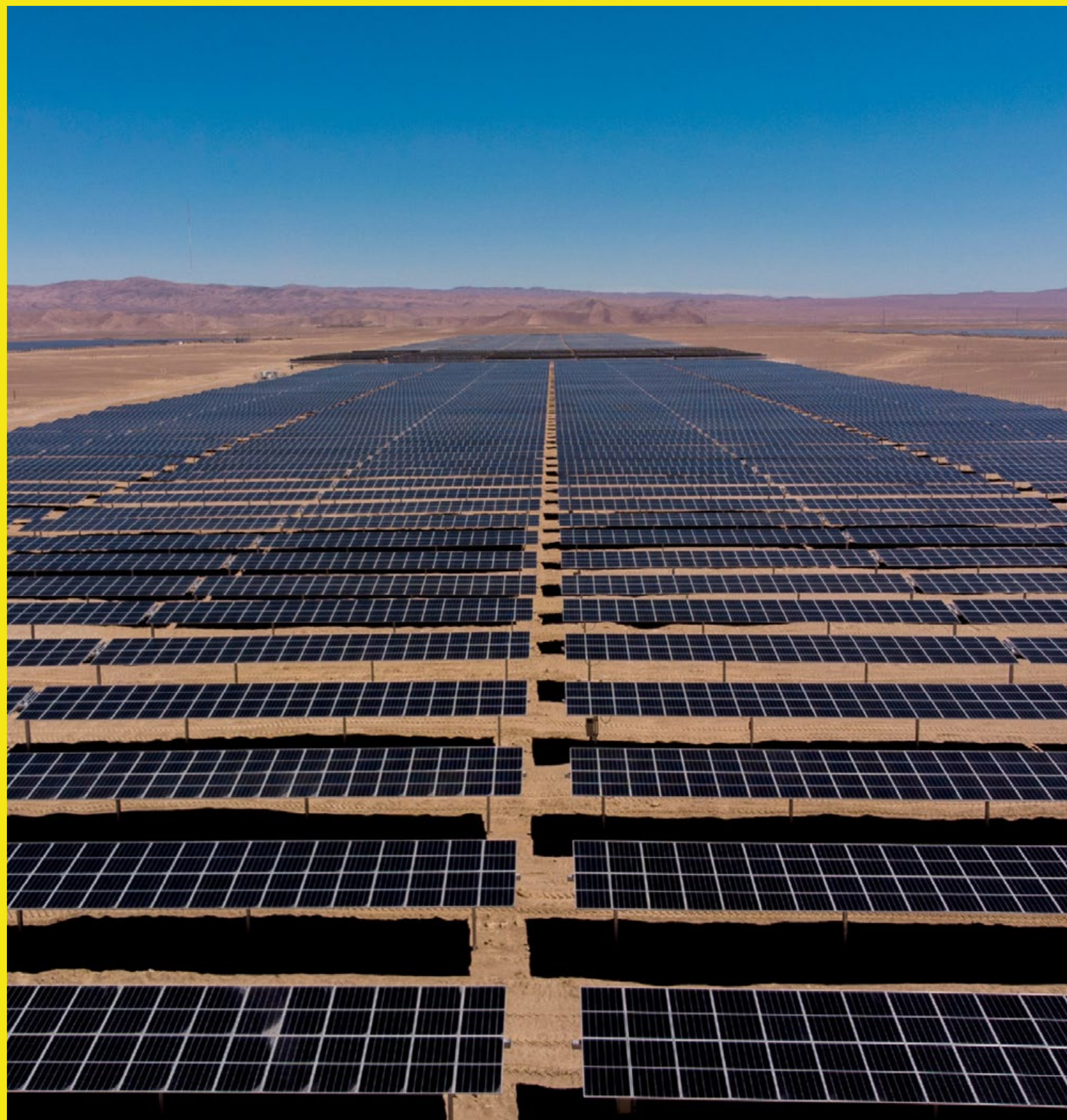
Planta FV Quillagua 103 MW, Chile
